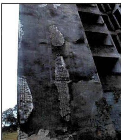
Vista da fachada lateral do bloco com armadura exposta
