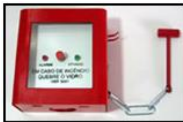
Botão de acionamento do alarme de incêndio
